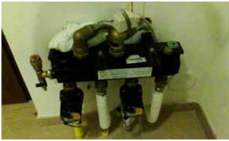
Abbildung 1a: Visuelles Bild eines Verteilers
